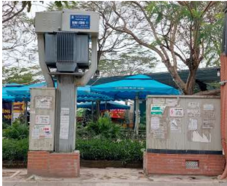
Trạm biến áp 1 cột trụ thép
