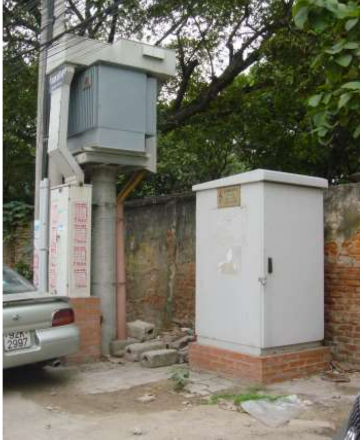
“Trạm biến áp phân phối” (còn gọi với tên: Trạm biến áp 1 cột trụ bê tông)
